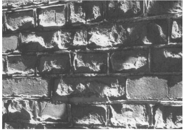
Een voorbeeld van vorstschade (Foto: Damage Atlas, 1998)
