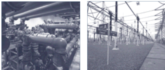
Verdeelstations in het elektriciteitsnet
